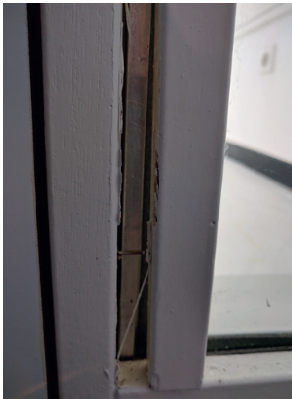
Achter de glaslat is de kenmerkende randtape van het brandwerend glas zichtbaar, helaas zijn de glaslatten genageld bevestigd.
