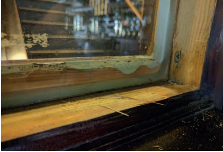
Kenmerkende verkleuring ter plaatse van de rand van de brandwerende giethars tussenlaag.
